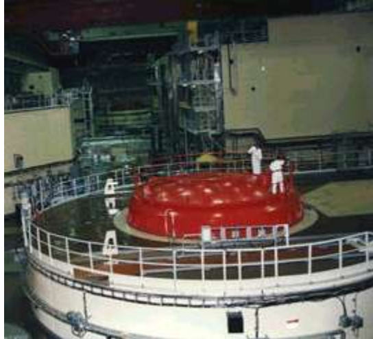
A paksi atomerőmű egyik 440 MW e névleges teljesítményű reaktora
